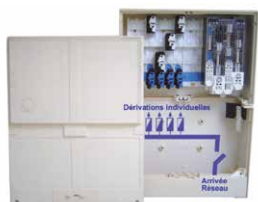
Photo : Coffret REM.BT avec 4 dérives individuelles monophasées
